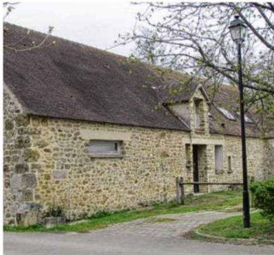
La ferme de Buloyer est inoccupée depuis le départ des Jardins de Cocagne en décembre 2016.
